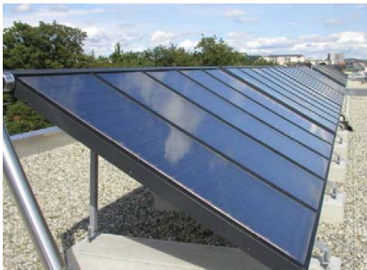
Abbildung 26: Große thermische Längen sind Voraussetzung bei „Low Flow“ Systemen und reduzieren gleichzeitig Kosten und Wärmeverluste
