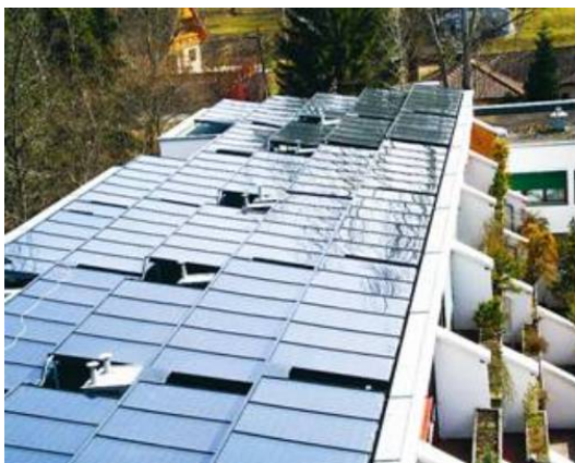
Abbildung 20: Eine nachträglich am Flachdach der Grazer Wohnanlage in der Hans-Riehl installierte Solaranlage mit 320 m 2 speist in das zentrale Warmwasserbereitungssystem (Bildquelle S.O.L.I.D.).
