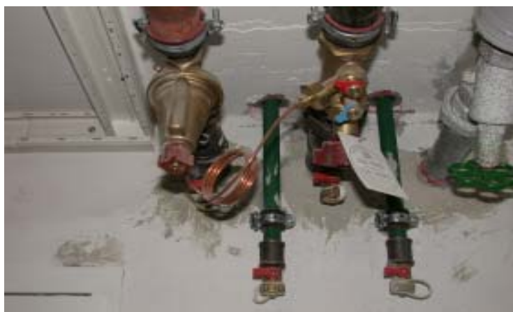
Abbildung 16: Einregeln der Steigstränge über Differenzdruckregler. Detail: Wartungsfreundliche Entlüftungsmöglichkeit von Steigsträngen im Kellergeschoß
