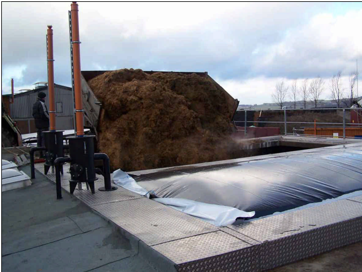
Abbildung 12: Befüllen des Fermenters [15]
