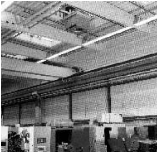
Bild 6.5 Produktions- halle ausge- rüstet mit dezentralem Lüftungssy- stem im Hallendach*
