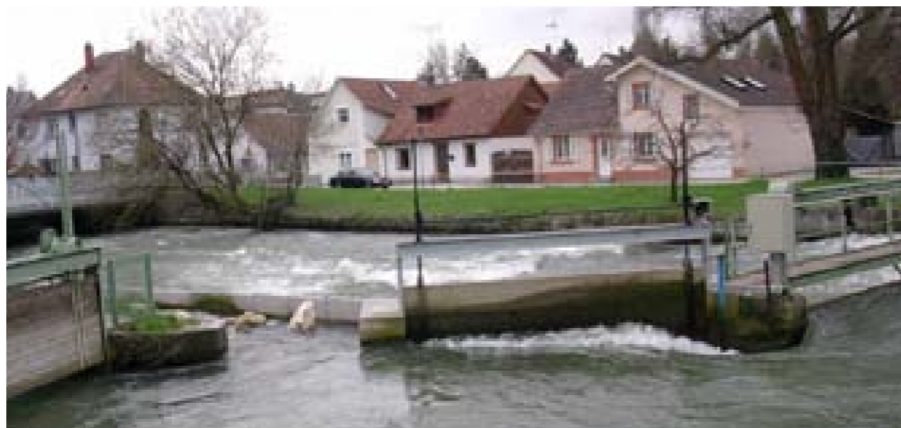
50 Reaktivierte Wasserkraftanlage an der Radolfzeller Aach
