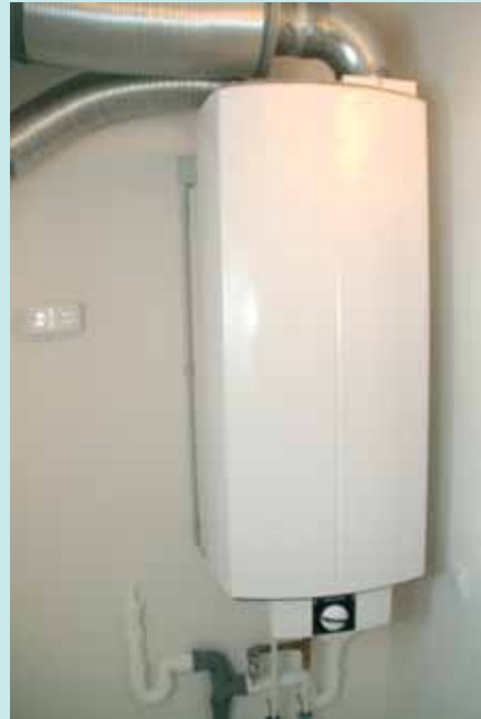
Lüftungsgerät mit integrierter Wärmepumpe und 100 l Brauchwasserspeicher, installiert in einem Abstellraum
