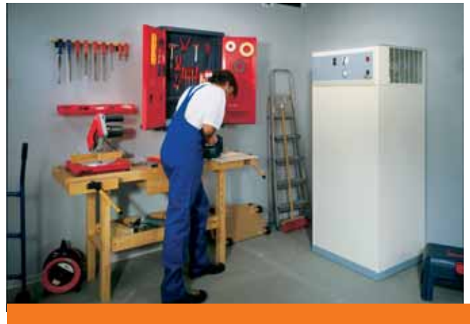
Installierte Brauchwasser-Wärmepumpe in einem Hobbyraum Foto: tecalor
