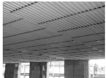
Abb.4: Deckenheiz-/kühlsystem in der Putzschicht integriert
