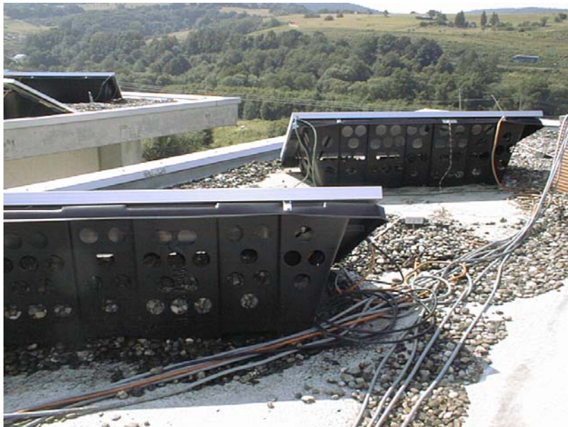
Abb. 7 Testsystem ist auf hinterlüfteten Wannen montiert
