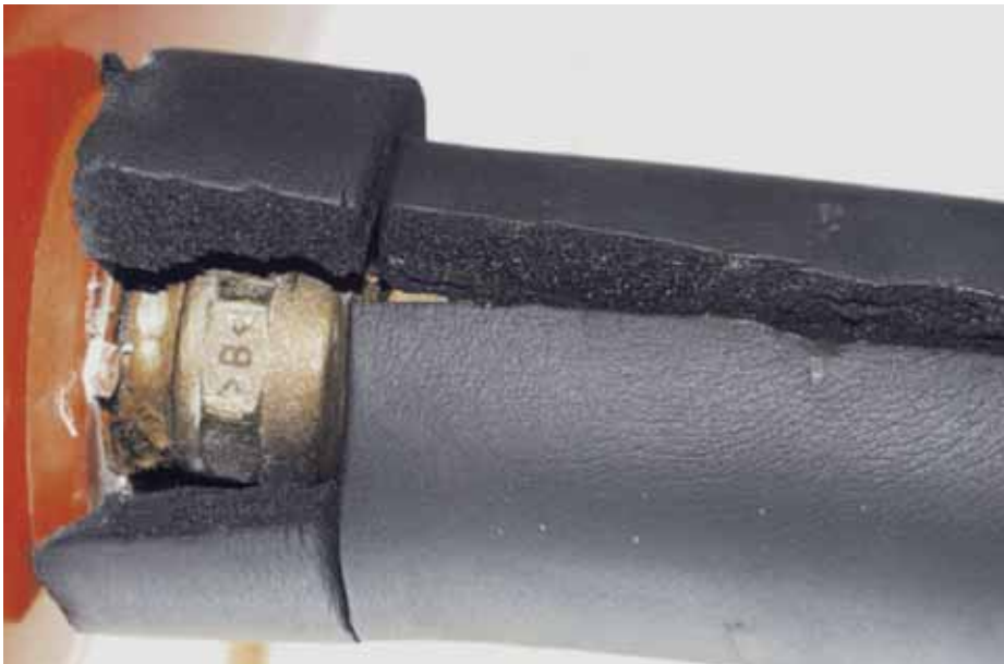
Mangel an einer Solarwärmanlage
