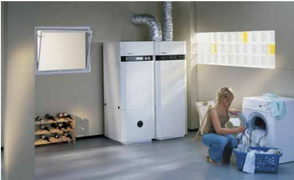
Geringer Platzbedarf: Wärmepumpe im Keller
