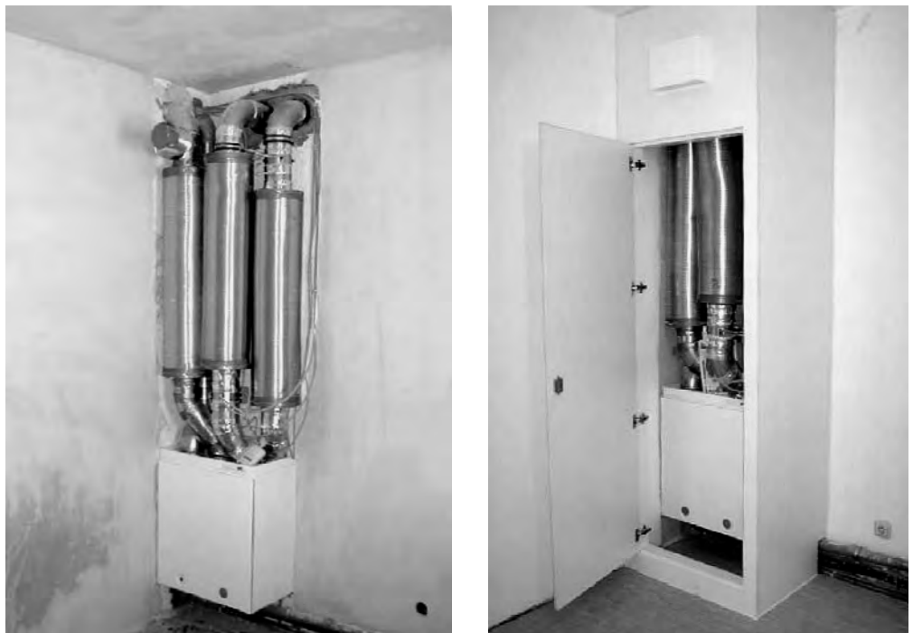
Abbildung 25: Lüftungsgerät während Bauphase und nach Fertigstellung
