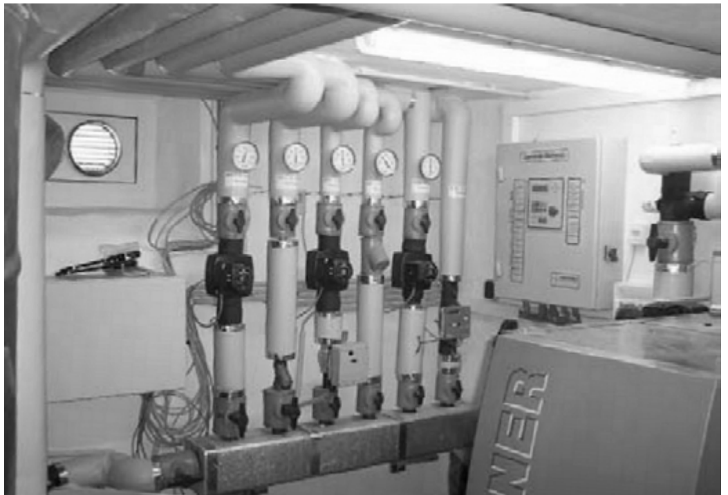
Abbildung 23:Heizzentrale mit Holzpelletkessel
