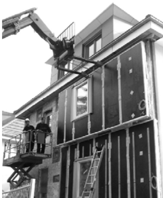
Abbildung 56: Hubstapler und Hebebühne
