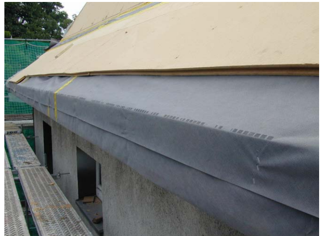
Abbildung 3.2-6: Außenansicht des Details links; untere Folie als Luftdichtung um Deckenbalken, die an WDVS angedichtet wird, obere ist die Unterspannbahn des Aufschieblings
