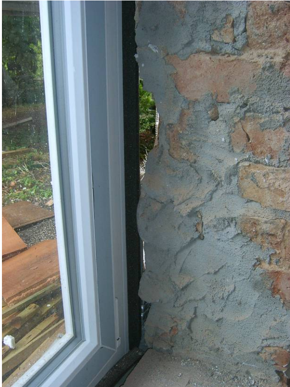
Abbildung 3.2-7: Fenstereinbau, noch nicht in Ordnung!
