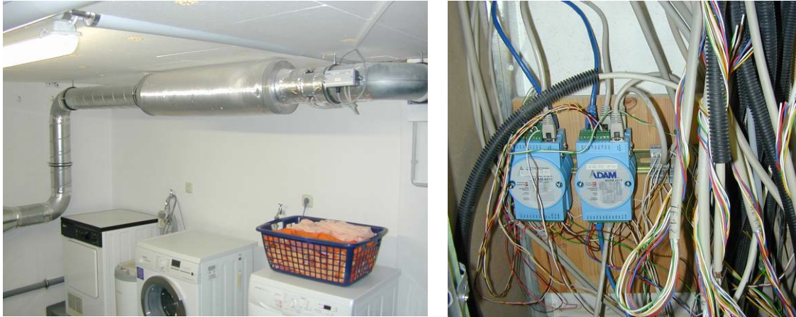
Abbildung 4.1-1: Datenlogger im Keller (links oben) und Raumtemperaturfühler im Wohnzimmer (rechts oben), Messblende mit Differenzdruckfühler im Keller ESH 60 (links unten) sowie Unterverteilung im Erdgeschoss während der Montage (rechts unten)
