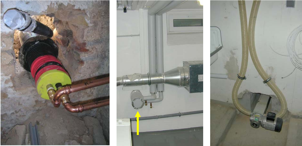
Abbildung 2.5-1 Links: Nahwärmedurchführung in den Gebäudekeller, Mitte: Die Nahwärmeleitung im fertigen Zustand (im Vordergrund Teile der Abluftanlage), rechts: Antrieb der Pelletförderschnecke mit Saugrohranschluss
