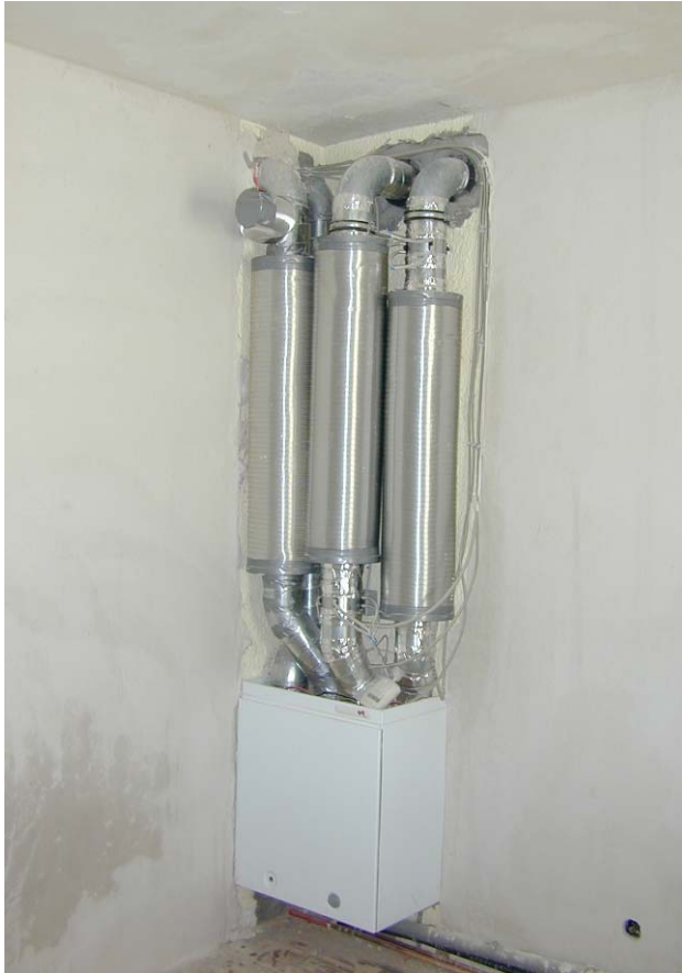
Abbildung 2.5-10: Lüftungsgerät in der Küche mit den Wanddurchbrüchen für Außen- und Fortluft
