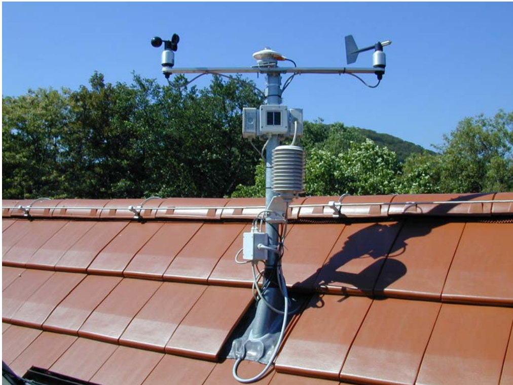
Abbildung 4.2-1: Ansicht der Klimastation auf dem Dach des ESH 60
