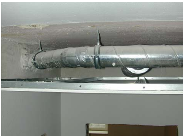
Abbildung 2.5-12: Zuluftverteilung in der abgehängten Decke im Flur jeder Wohnung
