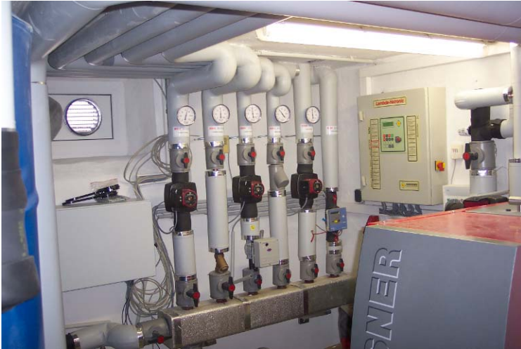
Abbildung 2.5-3 Verteilung der Wärme im zentralen Heizraum, rechts Pelletkessel
