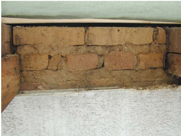
Abbildung 3.2-3: Mauerkrone unter Fußpfette, Ansicht von außen; seitlich sind die Balken des Dachüberstandes zu erkennen
