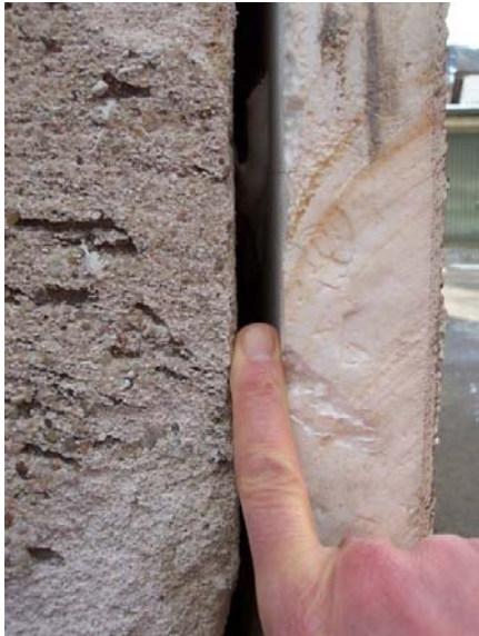
Abbildung 3.2-1 Hohlraum zwischen Bestandswand und altem WDVS durch Verklebung des WDVS mit Batzen
