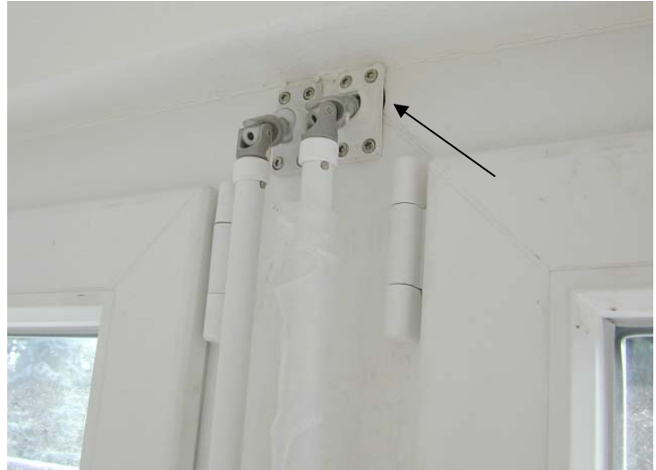
Abbildung 3.2-10: Rollladenkurbel versetzt montiert, musste nachgearbeitet werden
