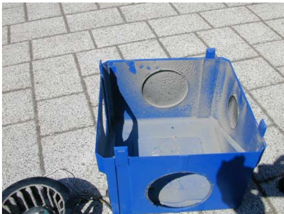
Ventilatorbox vor der Reinigung
