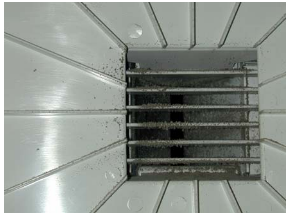
Verschmutztes Abluftventil in der Küche (Metallfilter entfernt)
