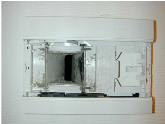
Verschmutztes Abluftventil im Badezimmer
