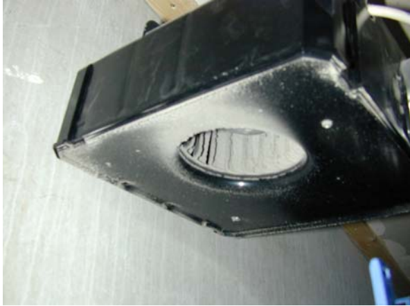
Abdeckung des Ventilators im verschmutzten Zustand
