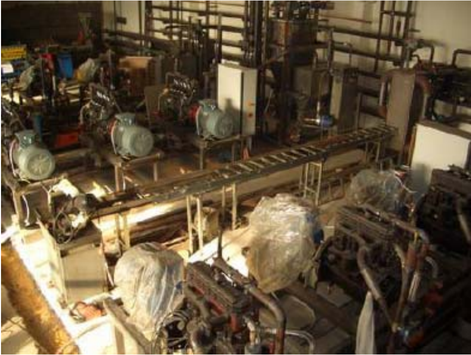
Abbildung 25: Eine aus drei Modulen bestehende Anlage mit 270 kW el während der Montage Ende Dezember 2008, Quelle: Vortrag von Herrn Baumann auf der CEP Stuttgart 2009
