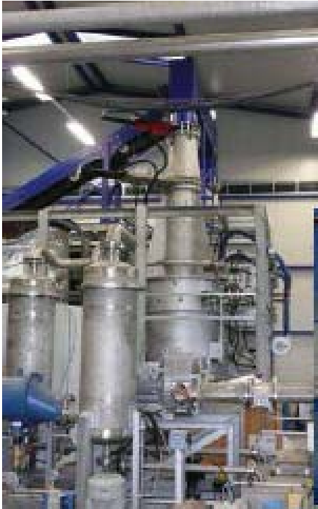
Abbildung 30: Reaktor der Holzgasanlage, Dortmund Anfang 2008, Darstellung bereitgestellt von Biomass Energiesysteme GmbH & Co KG
