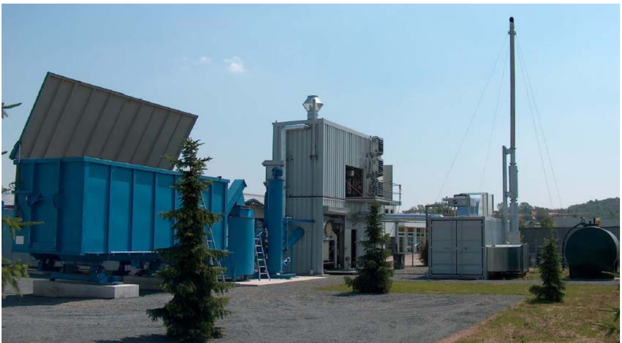
Abbildung 28: Bioampere® Anlage, Darstellung bereitgestellt vom Unternehmen
