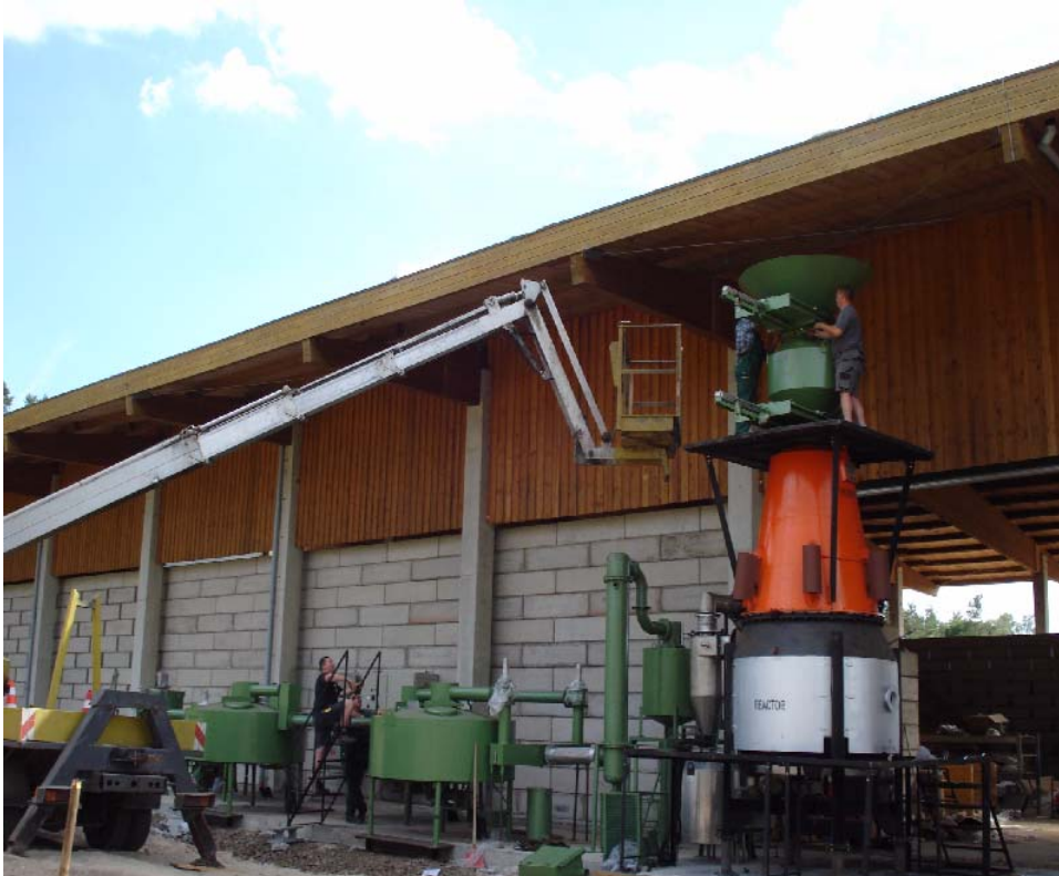
Abbildung 27: Aufbau eines ANKUR Holzvergaser-BHKW mit 250 kWel (ausgewählt um die Verfahrensstufen zu zeigen, seit 2008 komplett eingehaust und in Betrieb), Quelle: Vortrag von Herrn Menon im Februar 2008
