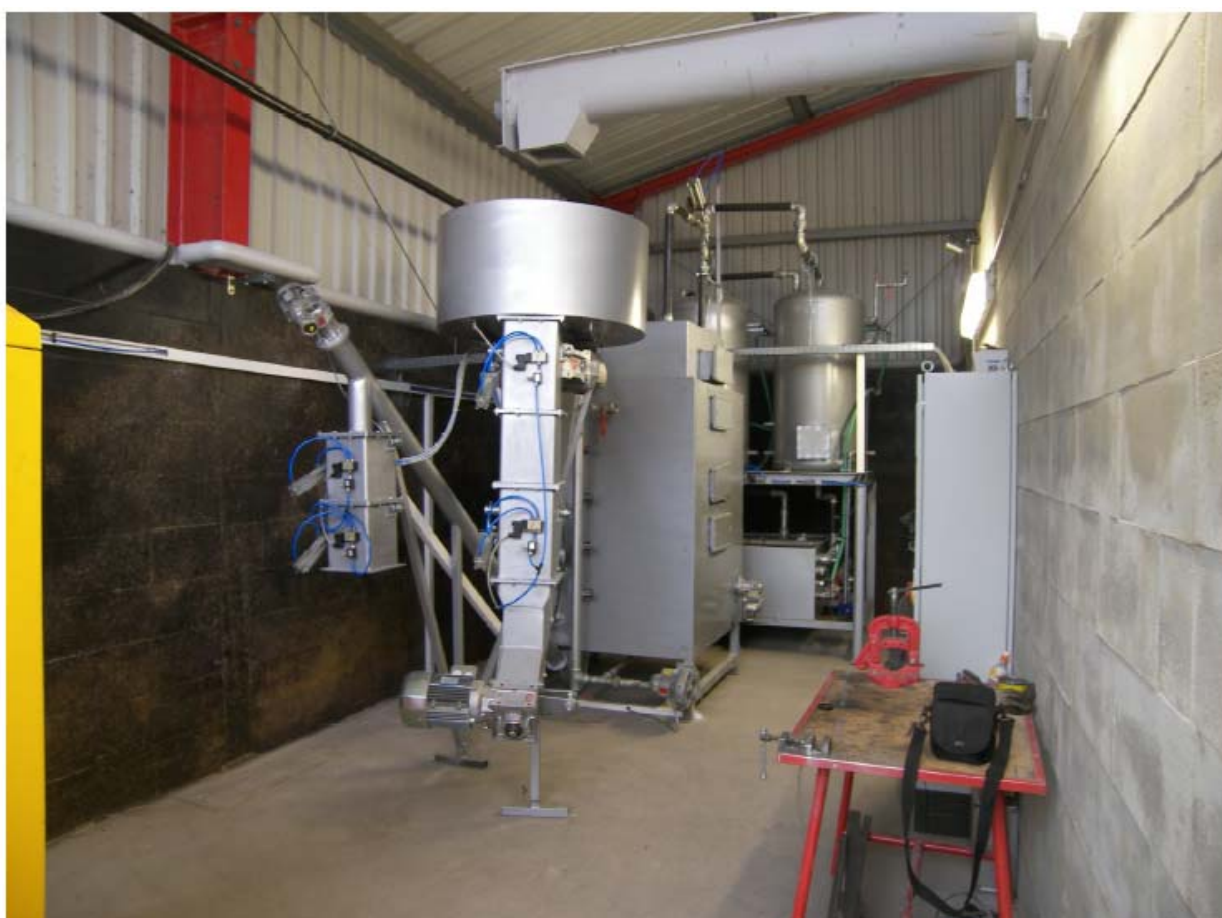
Abbildung 24: Gärreste Gaserzeuger zwischen Bremen und Hamburg im Test, Inbetriebnahme KW 3-4 2008, Darstellung bereitgestellt vom Hersteller
