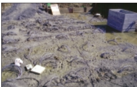
18 Installierte Erdwärmesonden in Neckarsulm
