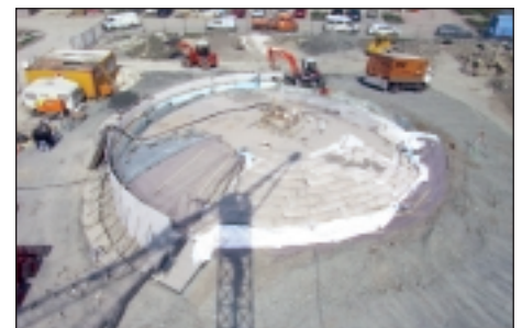
39 Heißwasser-Wärmespeicher in Hannover (PKI, Stuttgart)
